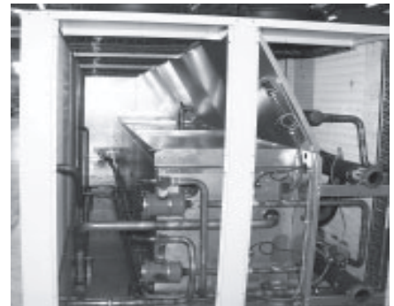
Geräuschkapselung des Verdichters
