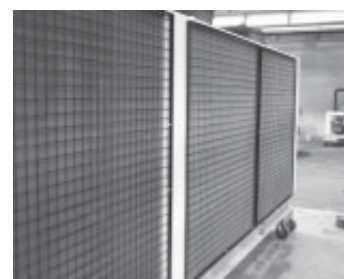
Protections de batterie de condenseur
