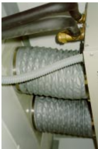
Fig. C – Condotti di Freecooling
