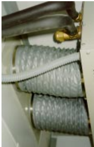
Fig. C – Conductos del Freecooling
