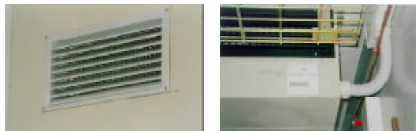
Fig. E – Rideau de surpression interne avec ouverture des ailettes vers l'extérieur et grille externe antipluie/antioiseaux correspondante
