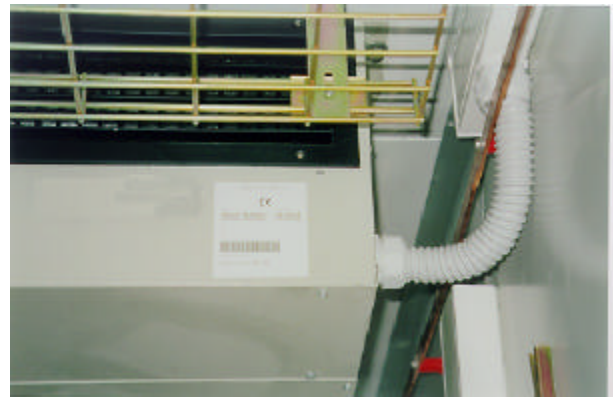
Fig. F – Détail des branchements électriques sur SE avec guide-câble et gaine en plastique (non fournis par nous)
