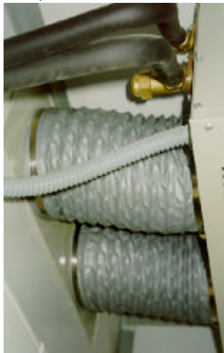
Fig. C – Conductos del Freecooling
