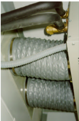
Fig. C – Condotto di Freecooling
