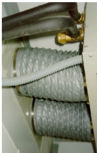
Fig. C – Conduites de Freecooling
