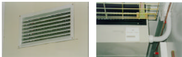
Abb. E – Innerer Überdruckregelklappe mit Lamellenöffnung nach außen und entsprechendem äußerem Regenschutzgitter mit Vogelsicherung.
