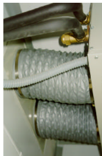
Fig. C – Condotti di Freecooling
