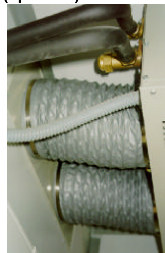
Fig. C – Conductos del Freecooling
