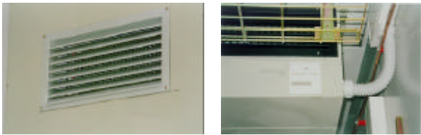
Fig. E – Compuerta interior de sobrepresión con apertura de las aletas hacia el exterior y rejilla exterior de protección contra la lluvia.
