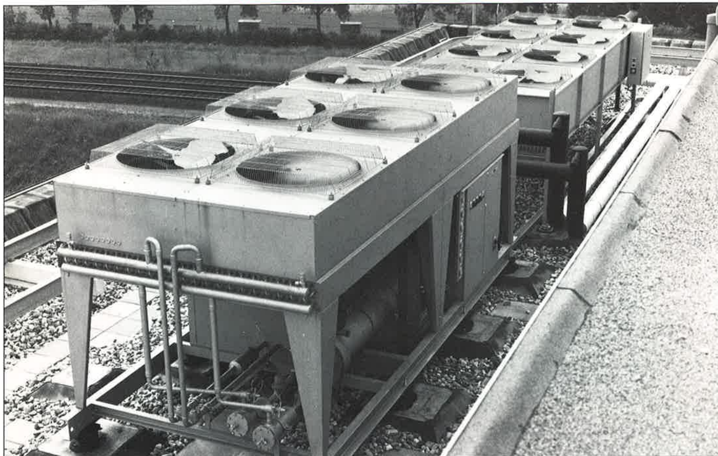
P.T.T.-Telecommunicatie heeft in het gebouw de "Hooghe Herven" te Den Bosch een Refac "low-noise" Airochiller PA 70D-LN in twee-circuit uitvoering laten installeren, die tesamen met de ernaast opgestelde Refac RLK 100/15/750 drycooler de computerzaal koelt door middel van 4 grote HIROSS down flow computer airconditioning units. (Adviseur Huisman en Van Muyen B.V., 's-Hertogenbosch, installateur Burgers Verwarming & Airconditioning B.V., Eindhoven.)
