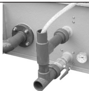
Circuit de bac de récupération du laveur d'air
