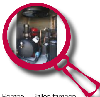
Pompe + Ballon tampon équipé de résistances électriques
